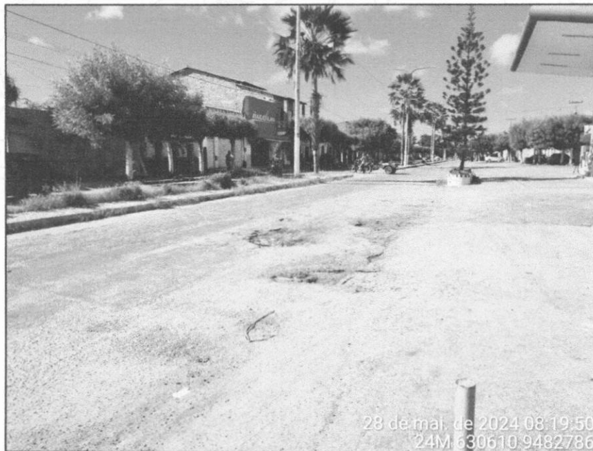
Figura 5: Trechos pavimentação esburacada
