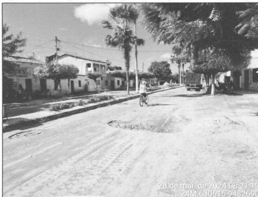
Figura 7: Trechos pavimentação esburacada
