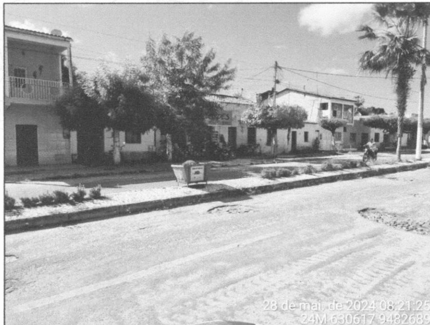
Figura 3: Trechos pavimentação esburacada
