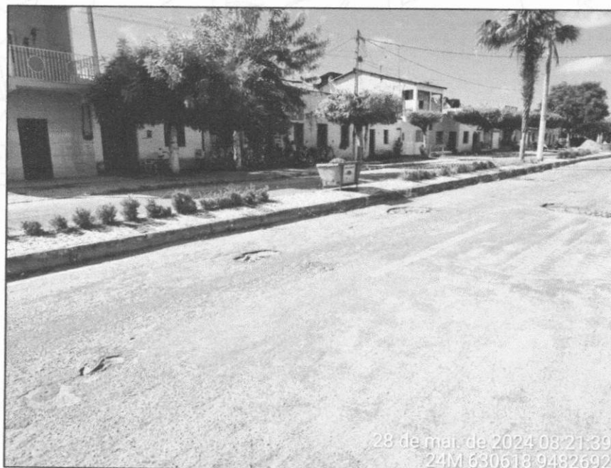
Figura 9: Trechos pavimentação esburacada
